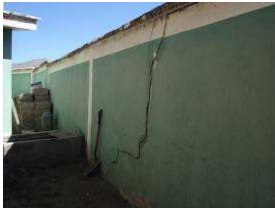
Cerca perimétrica del Reservorio Puerto Arturo presenta fisuras en cara lateral.
