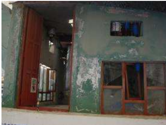
Caseta de cloración del reservorio Puerto Arturo se encuentra en mal estado, requiere mantenimiento.
