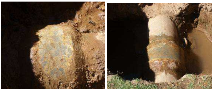
Tuberías de líneas de conducción de fierro corroídas y con fugas
