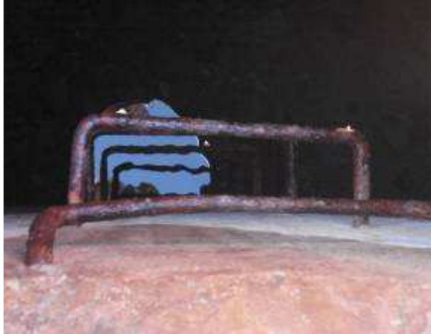
Escaleras de acceso presentan óxido.
