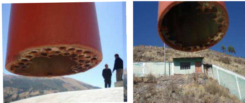
Tuberías de ventilación del Reservorio Puerto Arturo se encuentran deterioradas.
