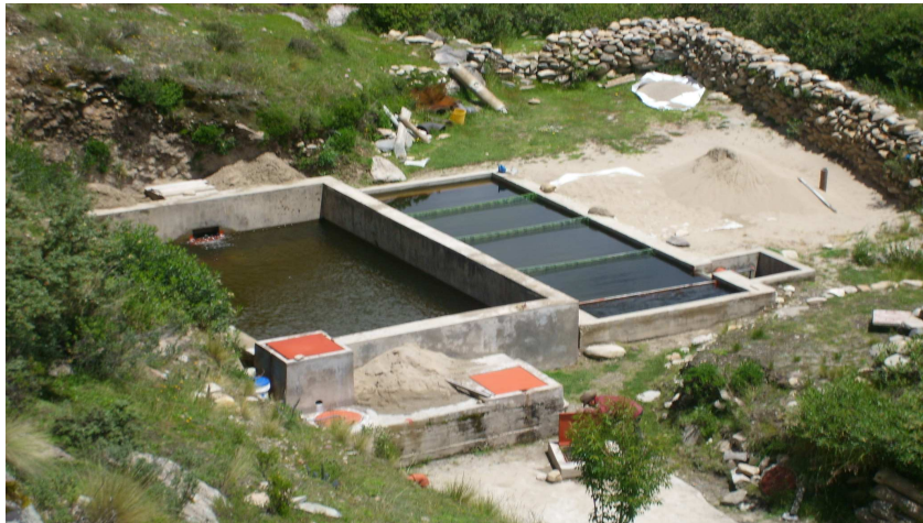
Planta de tratamiento cuenta con cámara de sedimentación y un filtro lento
