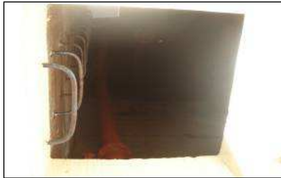
Cámara de válvulas del Reservorio Cashuarinas presenta filtraciones de agua en su interior.
