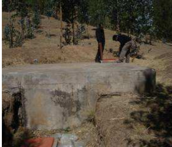
Reservorio Casuarinas del Sur no cuenta con cerco perimétrico.
