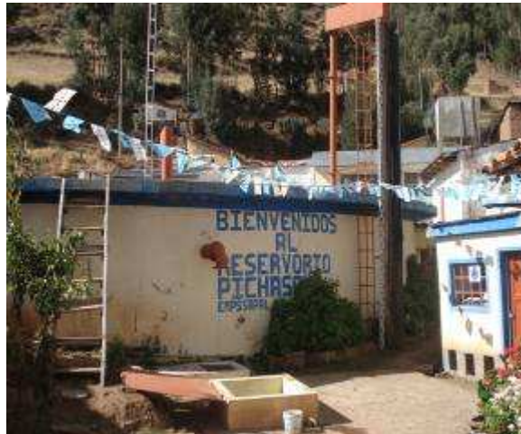
Reservorio Pichasani presenta filtraciones en cara lateral exterior.
